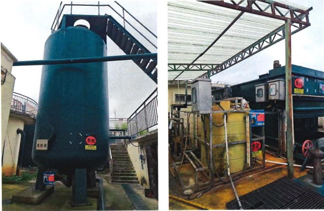
污水处理设施图片
